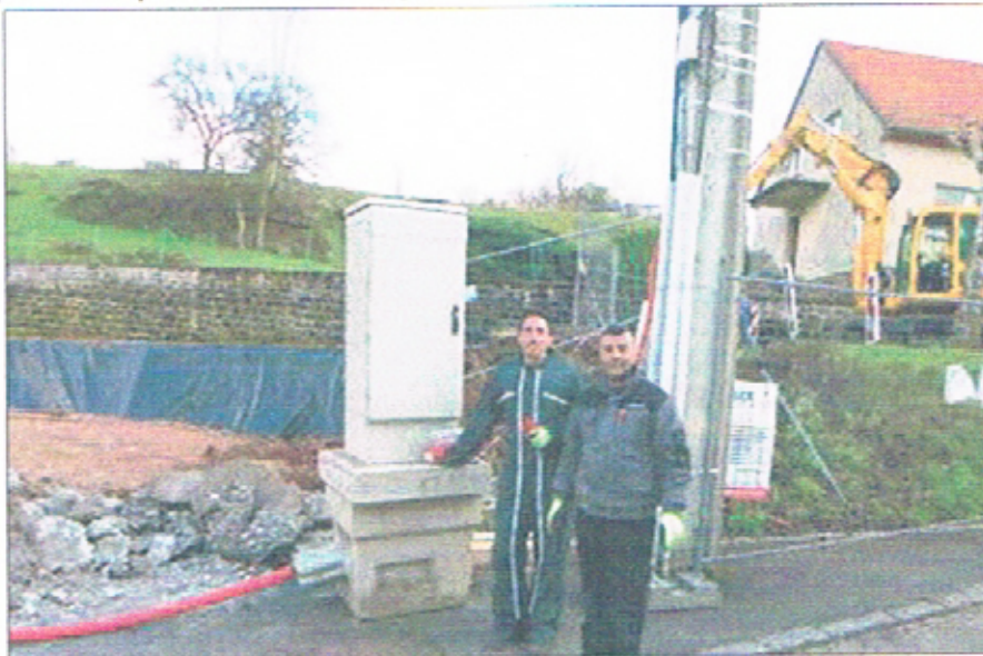
Partout dans le Pays de Bitche, comme ici à Volmunster, le réseau très haut débit Tubéo s'est construit. Mais il est aujourd'hui remis en cause par l'Arcep. Photos RL
